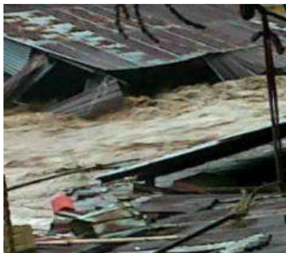
Gambar 6. Kondisi Bangunan Yang Hanyut Oleh Banjir Januari 2014
