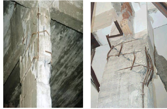
Foto 6 dan Foto 7. Efek confinement pada kolom
