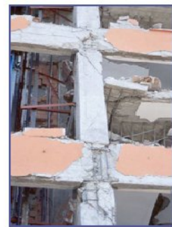
Foto 8 dan Foto 9. Kegagalan sambungan balok dan kolom
