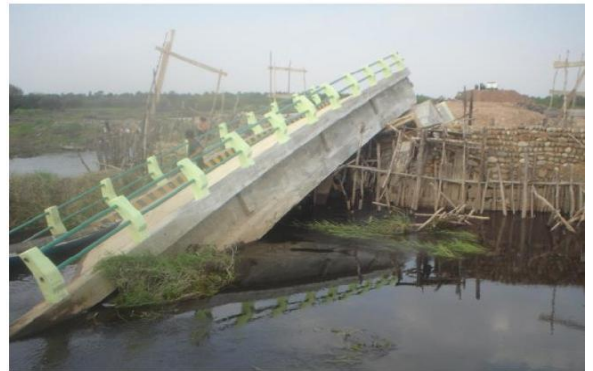
Gambar 8. Kerusakan konstruksi jembatan
