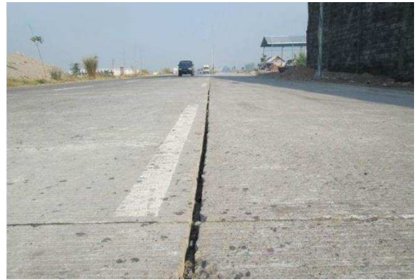
Gambar 6. Kerusakan jalan perkerasan kaku
