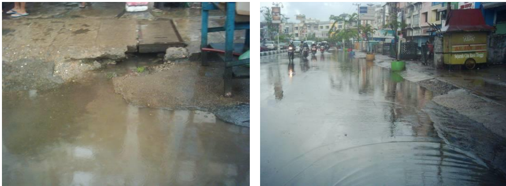
Gambar 3. Kondisi Genangan di Jalan A. Yani Banjarmasin
