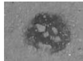
Gambar 2. Lubang pada Jalan
