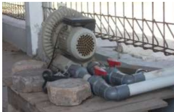
Gambar 5. Blower biogas di TPA
