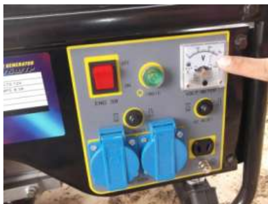
Gambar 15. Generator dalam keadaan langsung
