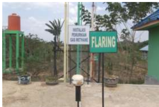
Gambar 4. Instalasi pemurnian di TPA Cahaya Kencana
