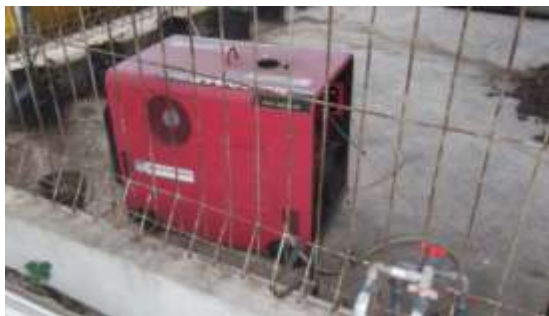
Gambar 6. Genset di TPA Cahaya Kencana
