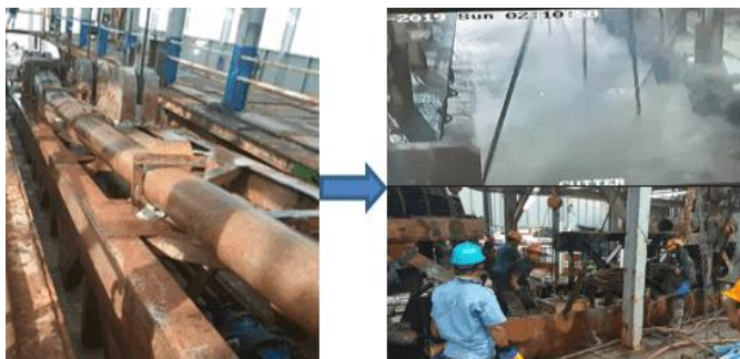
Gambar 9. Konstruksi ladder KIP Timah 19 yang mengalami gagal struktur pada brace pondasi katrol
