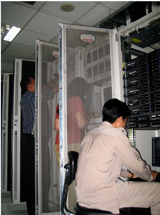
Perawatan data center di ruang server
