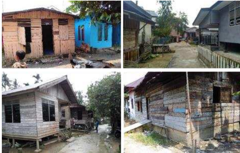
Gambar 2 Kondisi Bangunan Tidak Layak Huni
