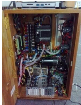
Gambar 5. Sistem Kontrol Elektronik
