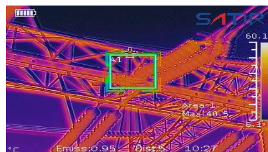
Gambar 3. hasil thermovisi sebelum perbaikan fasa S
