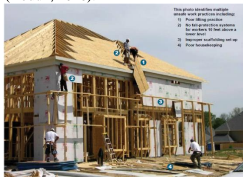
Gambar 1. Contoh pekerjaan konstruksi yang tidak aman (Sumber: OSHA, 2001)
