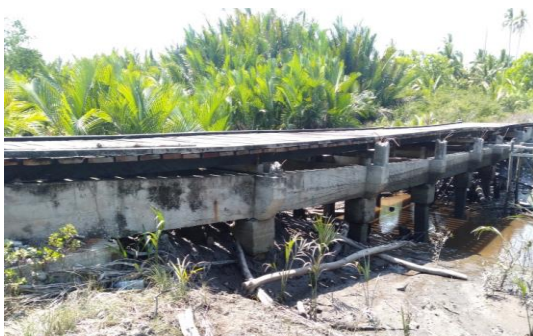
Gambar 1 Kondisi jembatan jalan datuk laksamana
