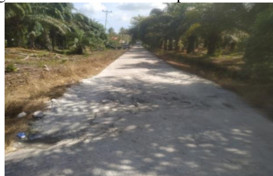
Gambar 7 Kondisi jalan existing pada STA 01+250
