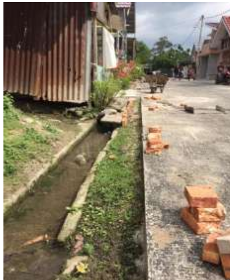
Gambar 1. Kondisi Jalan Sebelum Pelebaran
