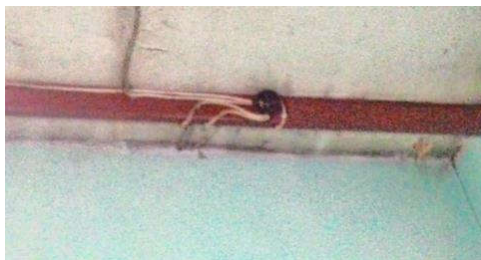
Gambar 4. Kontrakan nomer 1 milik H. Sarjiman yang berusia 17 tahun, kotak percabangan kabel yang tidak tertutup.
