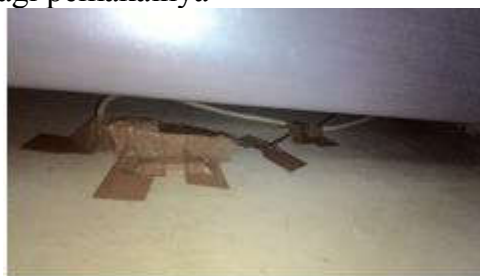
Gambar 2. Kontrakan nomer 1 milik Pak Harjo, stop kontak yang terlalu rendah sehingga ditutup dengan solatip.
