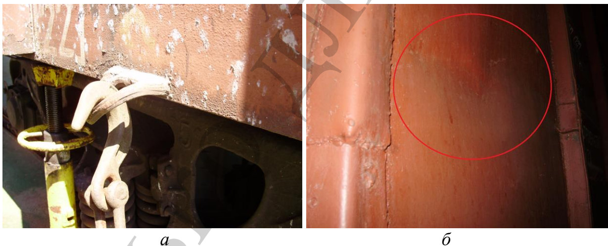
Рис. 1. Пошкодження елементів несучої конструкції кузова критого вагона: а – деформація буксирної скоби; б – деформація обшивки кузова
