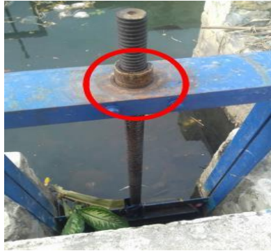
Gambar 4.10 Kerusakan Pintu Air BAL 5
