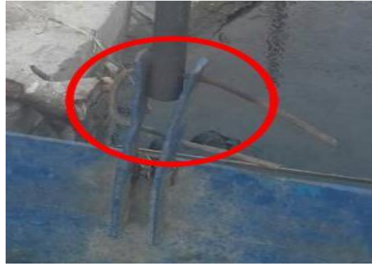
Gambar 4.8 Kerusakan Pintu Air BAL 5
