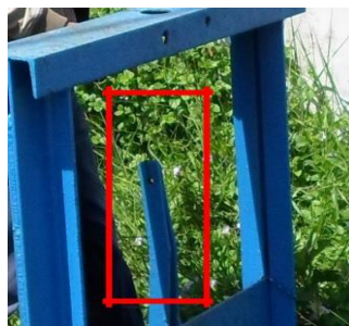
Gambar 4.12 Kerusakan Pintu Air BAL 6
