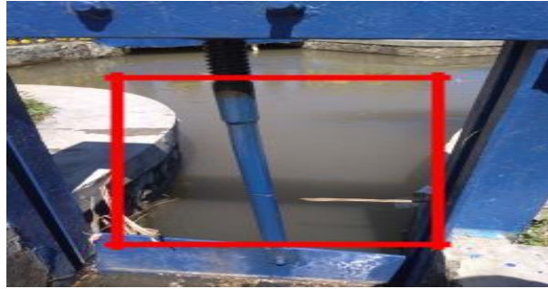
Gambar 4.6 Kerusakan Pintu Air BAL 3
