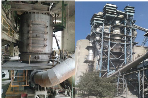
Gambar 2 Coal mill plant 8 (kiri) dan Suspension preheater plant 8 (kanan)
