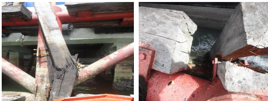
Gambar. 1 Kerusakan pelindung face fender jetty No. 1
