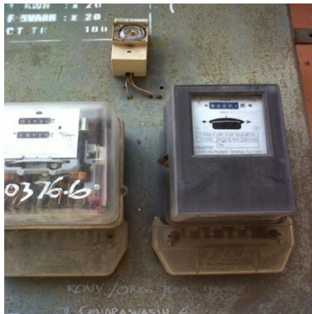
Gambar 4. Meter ganda ada pelanggan I-2
