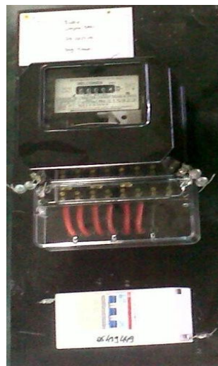
Gambar 3. Meter KWh yang terpasang pada pelanggan I-2 dengan daya 16.500 VA 3 fasa.
