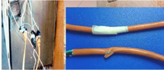
Gambar 6: Isolasi kabel yang buruk
