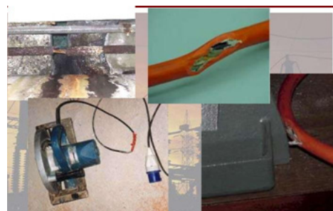
Gambar 5: Bagian kabel yang terbuka
