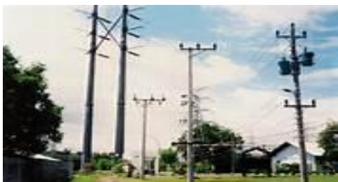
Gambar 2.2 Saluran Udara Tegangan Menengah
