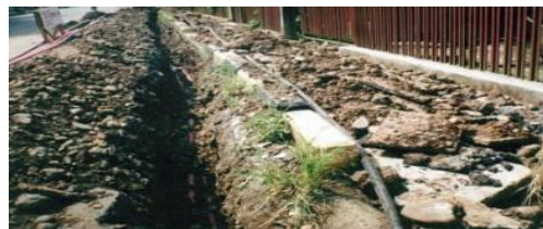
Gambar 2.3 Saluran Kabel Tegangan Menengah
