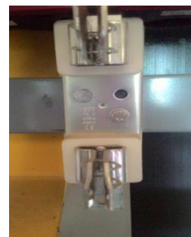
Gambar 6. Fuse Base Kondisi Baik
