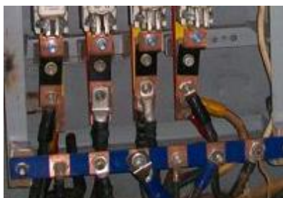
Gambar 8. Sepatu Kabel Kondisi Baik
