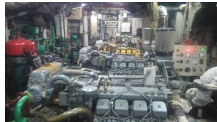
Gambar 2.16 ruang mesin diesel generator KRI Teluk Celukan Bawang 532
