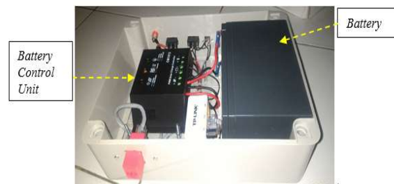
Gambar 7. Instalasi bagian kontrol sistem kamera
