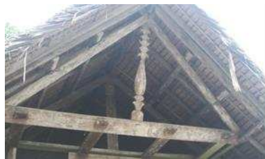
Gambar 18. Struktur Atap yang mempergunakan material kayu untuk usuk dan reng serta daun rumbia sebagai penutup atap
