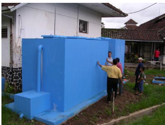
Gambar 15 : Unit alat pengolahan air limbah rumah sakit dengan sistem "Biofilter Anaerob-Aerob",
