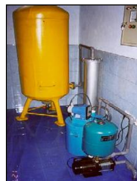
Gambar 3 : Pompa air Baku, Pompa Dosing, Static Mixer Dan Reaktor Oksidasi
