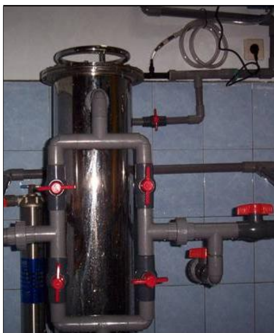
Gambar 9 : Filter Penukar Ion & Unit Regenerasi
