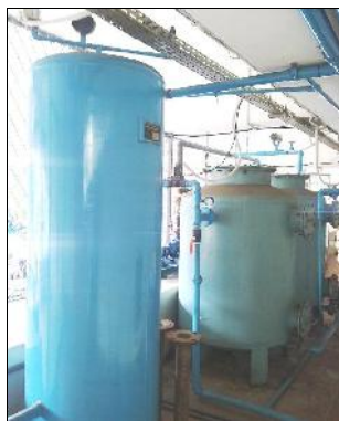
Gambar 8. Unit Daur Ulang Air Limbah BPPT Yang Ada Saat Ini
