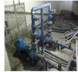
Gambar 10. Pompa Distribusi Air Hasil Olahan Daur Ulang
