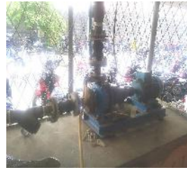
Gambar 9. Pompa Inlet Dari Air Hasil Pengolahan Limbah
