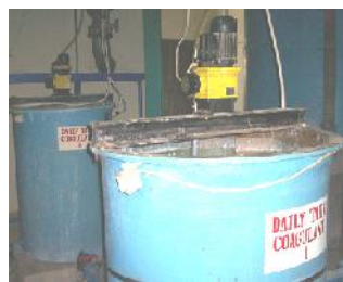
Pompa dosing koagulan (DSP)
