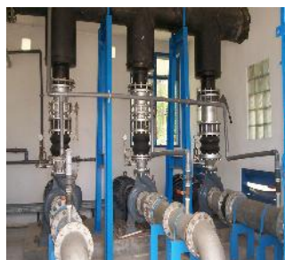
Pompa air baku (PAB)
