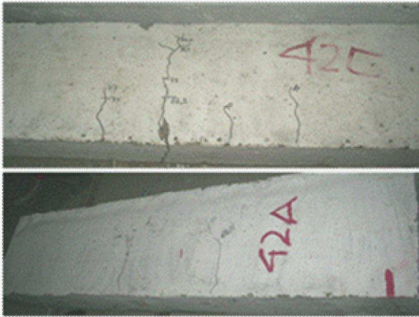
Gambar 7. Pola retak yang terjadi pada variasi tulangan tarik 4 D 7,8 mm
