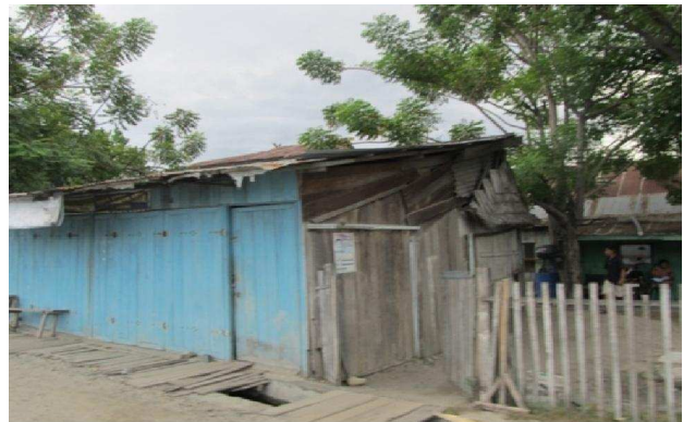
Gambar 10. Rumah kayu yang dibangun seadanya tanpa memperhitungkan beban gempa dan tsunami
