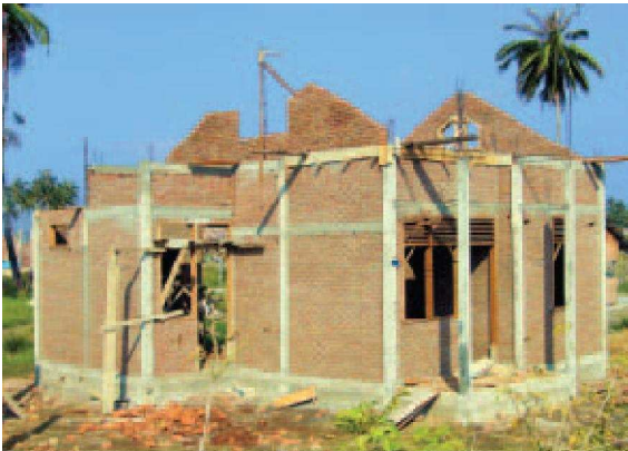
Gambar 13. Adanya cincin sebagai pengikat seluruh bangunan pada bangunan tahan gempa dan tsunami
