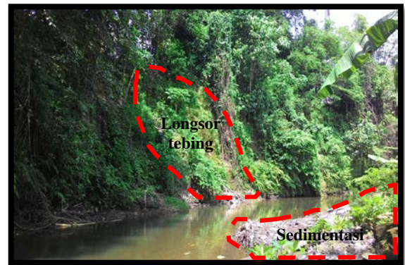
Gambar 5 Tebing sungai yang longsor di alur Sungai Code penggal Banteng-Gondolayu DI Yogyakarta (Kel. Sariharjo x : 431317 y : 9143785, 2015) Sumber : Foto lapangan (2015)
