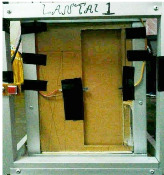
Gambar 4. Pintu lift Tampak Depan
