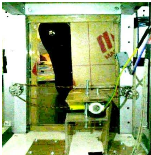
Gambar 5. Pintu Lift Tampak Dalam
