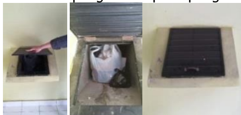
Gambar 13. Shaft Sampah (Sumber: Data Survey tanggal 12 Oktober 2015)
