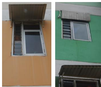
Gambar 5. Kondisi Kanopi Aluminium pada Rusunawa Cingised (Sumber : Survey 22/09/2015)
