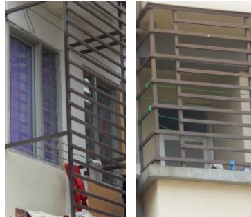
Gambar 7. Kondisi Vertical Blind pada Rusunawa Cingised (Sumber : Survey 22/09/2015)
