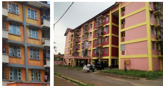
Gambar 1. Kondisi Dinding pada Rusunawa Cingised (Sumber : Survey 22/09/2015 )
