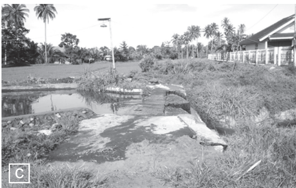
Gambar 1. Bendungan utama "water vang" (a), bangunan bagi (b) dan bendungan pada saluran yang dilakukan pemilik kolam air deras (c)
