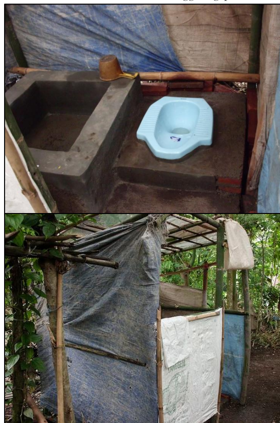
Pour flush latrines with tarp walls
