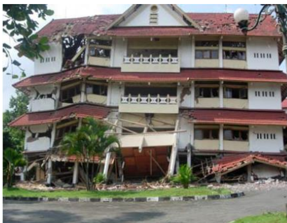
Gambar 2. Salah Satu Contoh Runtuhnya Bangunan Bertingkat (Widodo, 2007)
