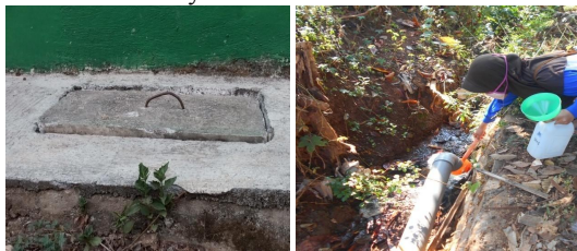
Gambar 9. Lubang Inlet/ Bak Kontrol dan Pipa Outlet
