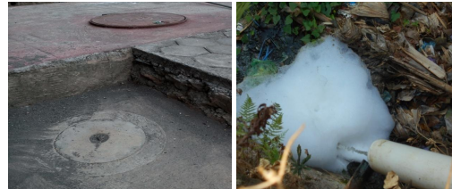
Gambar 6. Lubang Inlet/ Bak Kontrol dan Pipa Outlet ke Sungai
