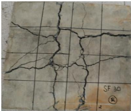
Gambar 7. Pola Retak Beton Normal + Dramix 30kg/m 3 (SF 30) Beban 156,8 kN
