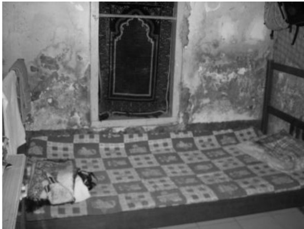
Gambar. 2. Kondisi kamar di panti asuhan Arif Rahman Hakim di Surabaya (sumber : http://pantiasuhan.info )
