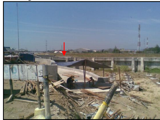
Gambar 4 Indikasi terjadinya pergeseran pondasi di salah satu retaining wall
