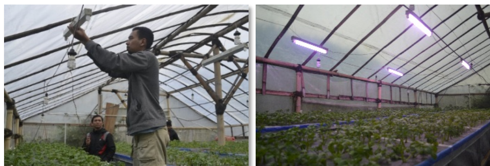
Gambar 9. Pemasangan LUMOS pada sistem aeroponik
