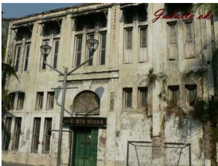
Gambar 8 Salah Satu Bangunan yang Mulai Hancur
