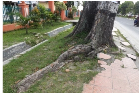
Gambar 2. Perakaran pohon mahoni ( Swietenia mahagoni ) yang merusak badan jalan
