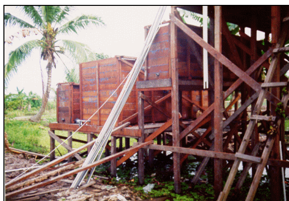
Gambar 7. Instalasi Pengolahan air gambut kontinyu
