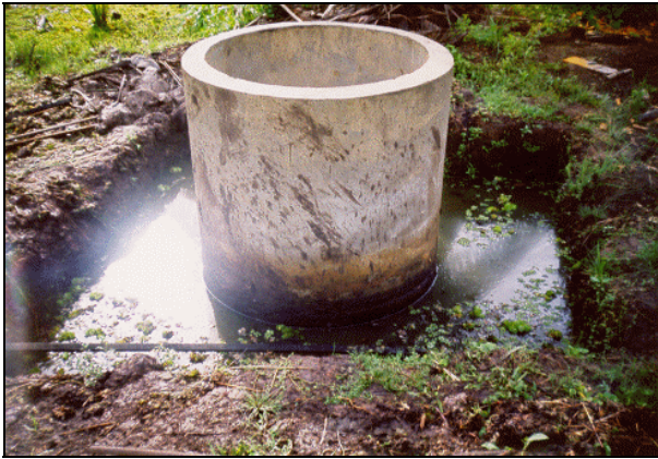
Gambar 3. Sumur sumber air baku
