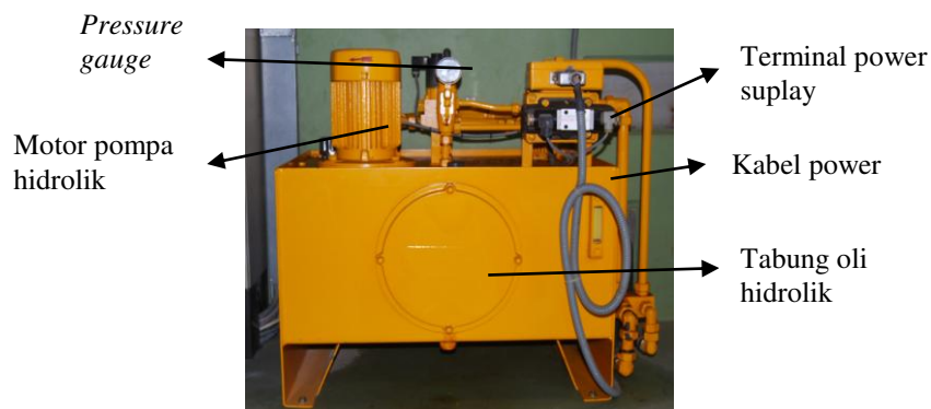
Gambar 5. Pompa hidrolik di ruang 005 basement .
