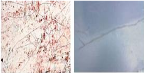
Gambar 8. Bentuk kerusakan/keretakan pelat zona lambung
